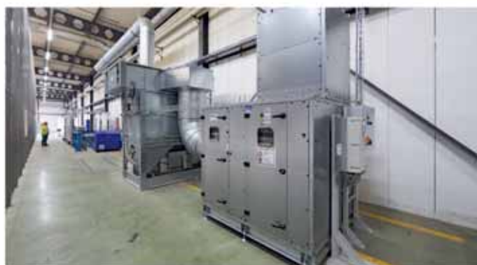
In der Entstaubungsanlage gereinigte Prozessluft trägt zu einem sauberen, von Kartonstaub befreiten Raumklima bei.
