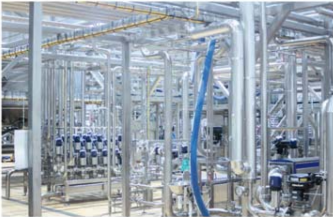
Die Informationen aus zahlreichen Messstellen und Ventilsteuerungsköpfen entlang der Rohrleitungen werden mittels AS-i und IO-Link an die IT-Ebene weitergeleitet. (Alt: Rohrleitungen aus Edelstahl mit Automatisierungstechnik)
