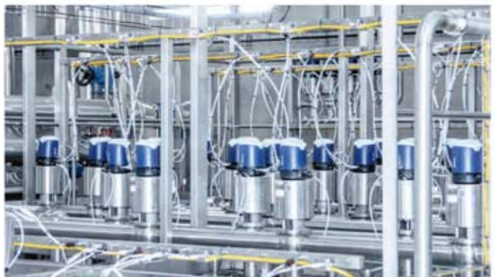
Das markante gelbe AS-i Flachkabel zieht sich durch die gesamte Prozesskette. Hierüber werden auch die Informationen der Sorio-Ventilsteuerköpfe von Definox nahtlos übertragen. (Alt: AS-i Kabel an einer Ventilinsel)
