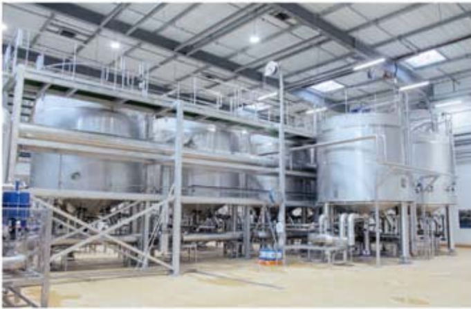
Zahlreiche Tanks und Rohrleitungen mussten im Zuge der Modernisierung mit Sensorik ausgestattet werden. (Alt: Edelstahl-Tanks in einer Werkshalle)
