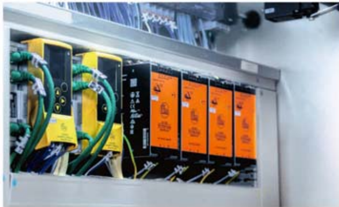
Schnittstelle zwischen OT und IT. Im Schaltschrank sind AS-i Stromversorgung, sichere AS-i Ausgangsmodule und AS-i Ethernet/IP-Gateways verbaut. (Alt: Schaltschrank mit diversen AS-i Modulen)
