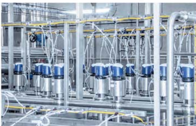
Das markante gelbe AS-i Flachkabel zieht sich durch die gesamte Prozesskette. Hierüber werden auch die Informationen der Sorio-Ventilsteuerköpfe von Definox nahtlos übertragen. (Alt: AS-i Kabel an einer Ventilinsel)
