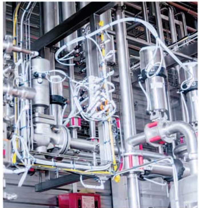
AS-i trifft IO-Link: Beide digitalen Kommunikationstechnologien lassen sich ideal miteinander vernetzen, sodass sich die Vorzüge auch kombiniert nutzen lassen. Hier werden unter anderem Durchfluss, Druck und Temperatur via IO-Link an AS-i übermittelt. (Alt: AS-i Kabel und IO-Link-Master an Rohrleitungen mit Sensoren und Ventilsteuerköpfen)
