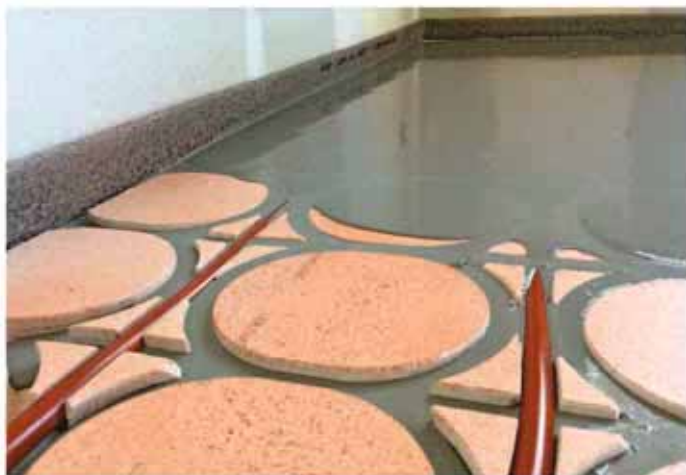
Am Schluss wird der Boden mit der zementären Vergussmasse vergossen. Sie bildet die Grundlage für den späteren Bodenbelag.
